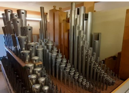
Teile von Pedalwerk und Oberwerk
